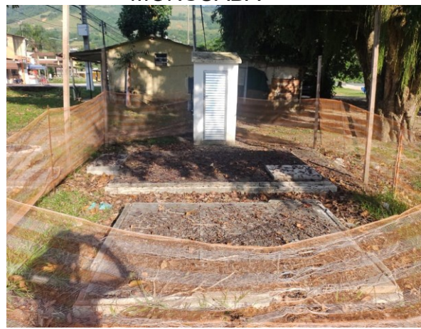
FIGURA 6-175 – ESTAÇÃO ELEVATÓRIA DA ETE MONSUABA
