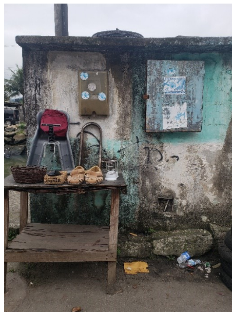
FIGURA 6-88 – EEE TARARACA – PADRÃO DE QUADRO ELÉTRICO
