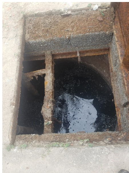
FIGURA 6-80 – EEE PALMIRA – POÇO DE SUÇÃO
