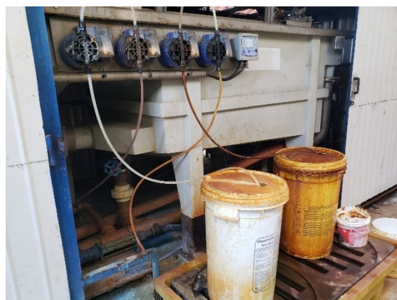
FIGURA 6-142 – ETE – TRATAMENTO FÍSICO-QUÍMICO
