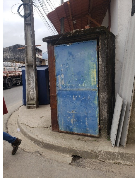
FIGURA 6-5 – EEE AV. MAGALHÃES – ABRIGO DO QUADRO ELÉTRICO
