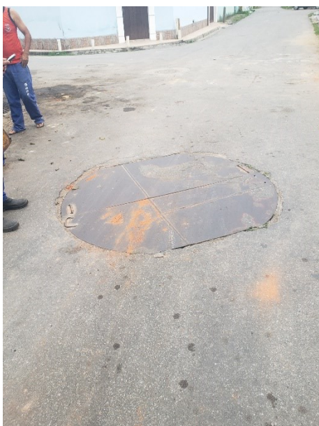
FIGURA 6-81 – EEE ALVORADA – VISTA GERAL
