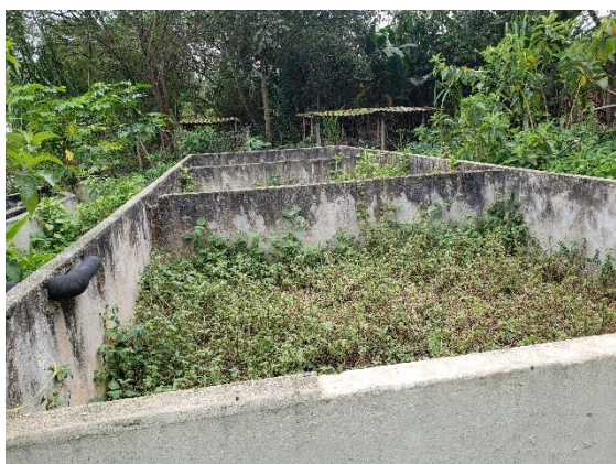
FIGURA 6-76 – LEITO DE SECAGEM DE LODOS
