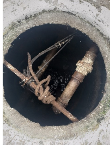
FIGURA 6-37 – EEE 03 – POÇO DE SUÇÃO
