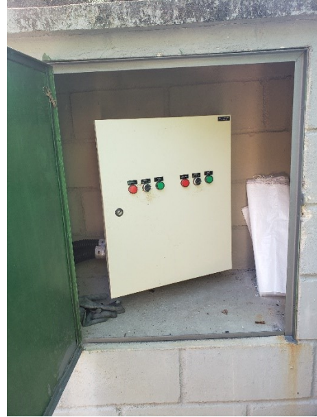
FIGURA 6-206 – ETE PROVETÁ – EEE – QUADRO ELÉTRICO
