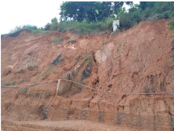
FIGURA 7-10 – ESCORREGAMENTO NA ESTRADA PARA PONTA LESTE
