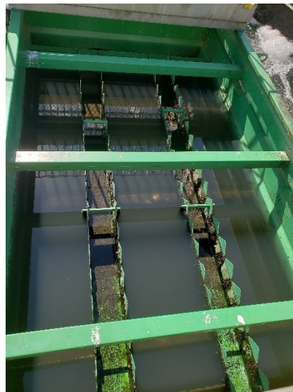
FIGURA 6-128 – ETE PRAIA DA CHÁCARA – DECANTADOR
