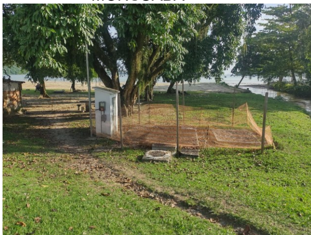
FIGURA 6-174 – ESTAÇÃO ELEVATÓRIA DA ETE MONSUABA
