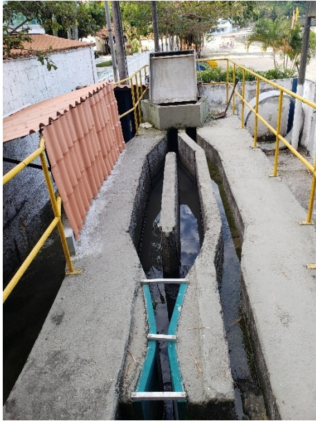
FIGURA 6-135 – ETE – TRATAMENTO PRELIMINAR
