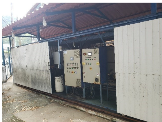
FIGURA 6-141 – ETE – TRATAMENTO FÍSICO-QUÍMICO – QUADROS ELÉTRICOS
