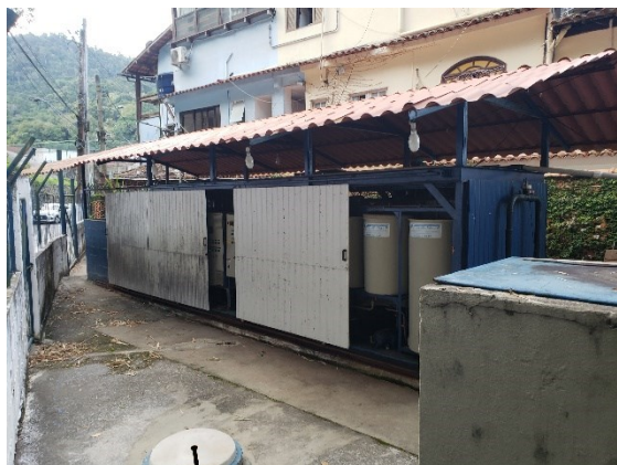
FIGURA 6-139 – ETE – TRATAMENTO FÍSICO-QUÍMICO
