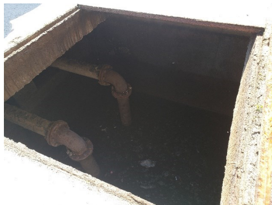
FIGURA 6-118 – EEE HOTEL – POÇO DE SUÇÃO
