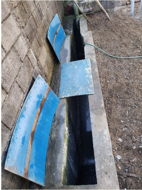
FIGURA 6-149 – ETE VILA VELHA – TRATAMENTO PRELIMINAR
