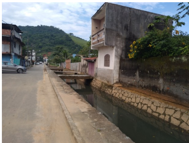
FIGURA 7-17 – OCUPAÇÃO DAS MARGENS DOS CANAIS DE DRENAGEM
