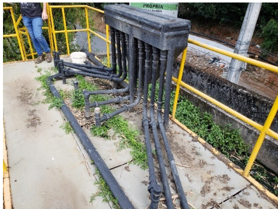
FIGURA 6-137 – ETE – CAIXA DE DISTRIBUIÇÃO DO RAFA
