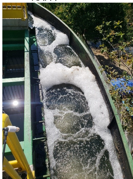
FIGURA 6-126 – ETE PRAIA DA CHÁCARA – PÓS-TRATAMENTO AERADO
