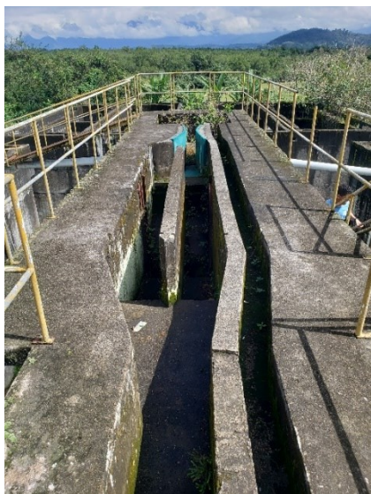
FIGURA 6-91 – ETE JAPUÍBA – TRATAMENTO PRELIMINAR
