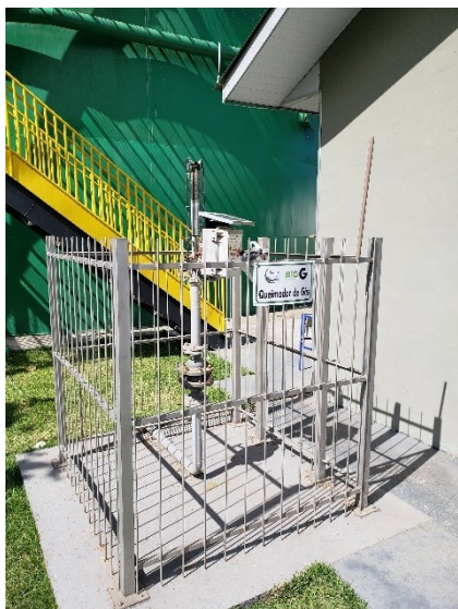
FIGURA 6-131 – ETE PRAIA DA CHÁCARA – QUEIMADOR DE GÁS
