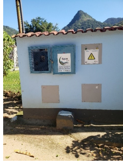
FIGURA 6-195 – EEE 02 – PADRÃO COM QUADRO ELÉTRICO
