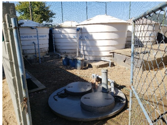
FIGURA 6-154 – ETE VILA VELHA – VISTA GERAL INCLUINDO EEE E SISTEMA DE RAC+BAS
