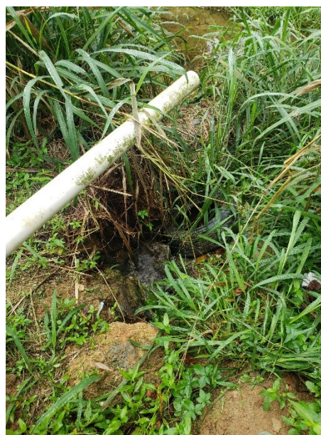
FIGURA 6-59 – LANÇAMENTO DE ESGOTO EM TERRENO
