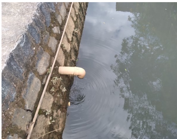
FIGURA 7-16 – LANÇAMENTO DE ESGOTO EM CANAL DE DRENAGEM
