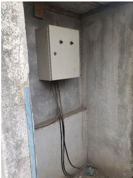
FIGURA 6-6 – EEE AV. MAGALHÃES – QUADRO ELÉTRICO
