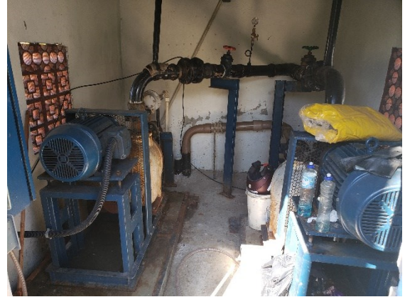
FIGURA 6-109 – EEE ANIL – CONJUNTOS MOTO-BOMBA
