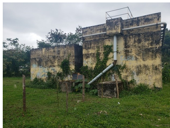
FIGURA 6-56 – ETE FRADE – REATOR UASB E FILTRO ANAERÓBIO
