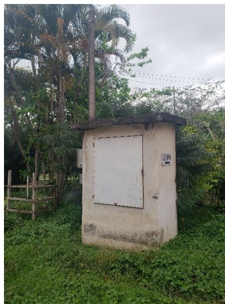
FIGURA 6-50 – ETE RAIMUNDO CAPRIANO – QUADRO DE COMANDO
