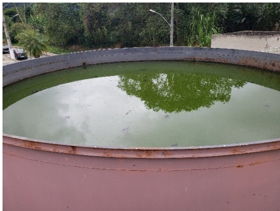
FIGURA 6-72 – TANQUE DE AERAÇÃO
