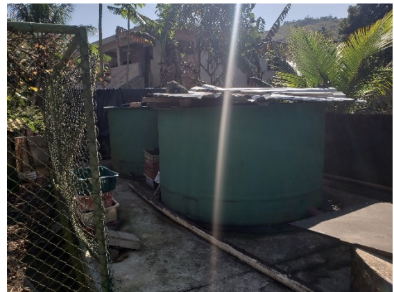
FIGURA 6-208 – ETE PROVETÁ – LEITOS DE SECAGEM
