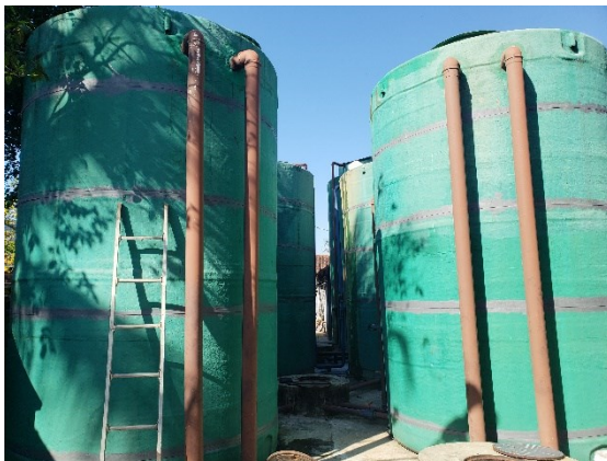
FIGURA 6-207 – ETE PROVETÁ – TANQUES DE TRATAMENTO
