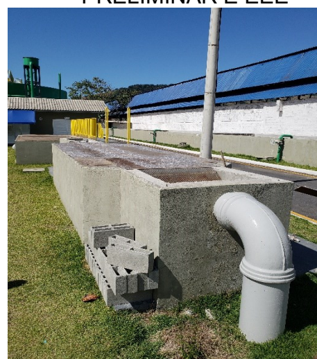
FIGURA 6-122 – ETE PRAIA DA CHÁCARA – TRATAMENTO PRELIMINAR GRADEAMENTO
