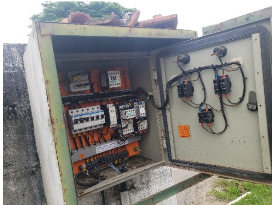
FIGURA 6-38 – EEE 03 – QUADRO DE COMANDO
