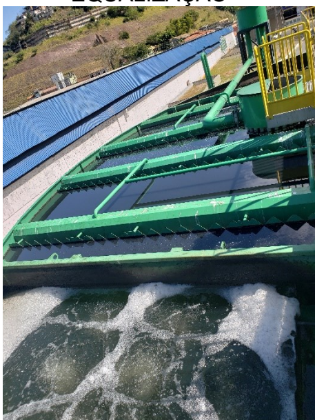
FIGURA 6-125 – ETE PRAIA DA CHÁCARA – REATOR RAFA – VISTA SUPERIOR
