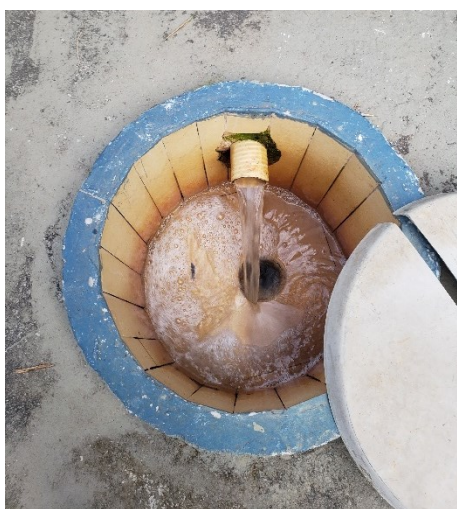
FIGURA 6-143 – ETE – EFLUENTE FINAL
