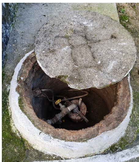
FIGURA 5-90 – VISTA DO POÇO ARTESIANO – SAA BONFIM 01
