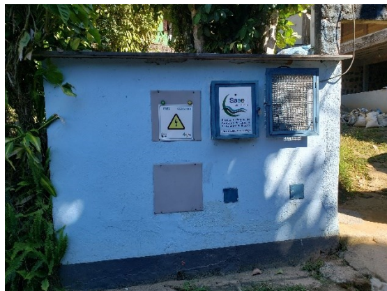
FIGURA 6-183 – EEE 06 – PADRÃO COM QUADRO ELÉTRICO
