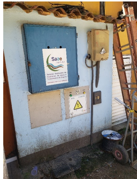
FIGURA 6-189 – EEE 04 – PADRÃO COM QUADRO ELÉTRICO
