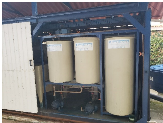
FIGURA 6-140 – ETE – TRATAMENTO FÍSICO-QUÍMICO
