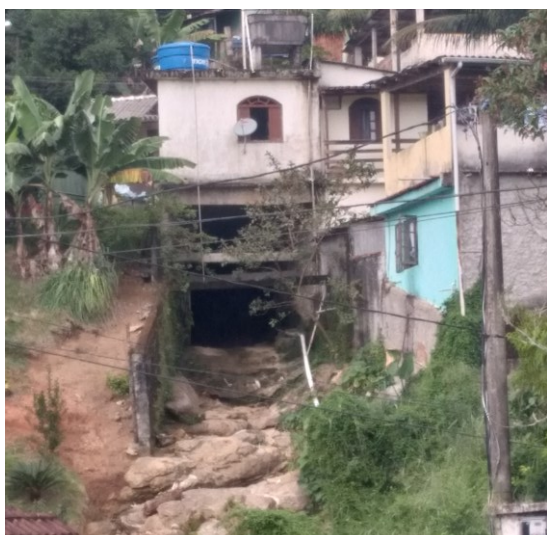
FIGURA 7-18 – EDIFICAÇÃO SOBRE GALERIA DE ÁGUA PLUVIAL
