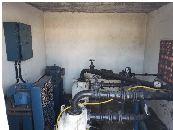
FIGURA 6-106 – EEE PATROMORIA – CONJUNTOS MOTO- BOMBA E QUADRO ELÉTRICO
