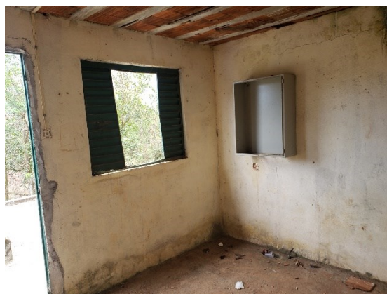
FIGURA 6-21 – ETE PARQUE MAMBUCABA – ABRIGO DO QUADRO ELÉTRICO
