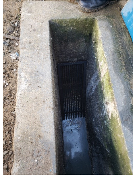
FIGURA 6-150 – ETE VILA VELHA – TRATAMENTO PRELIMINAR GRADEAMENTO
