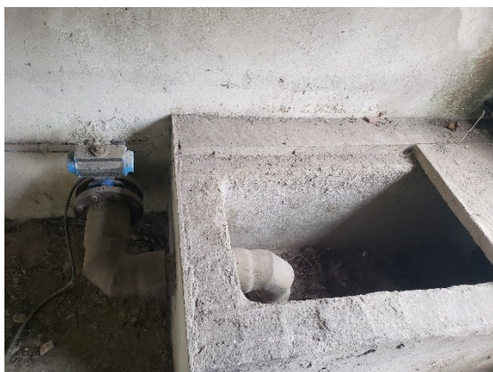
FIGURA 6-20 – ETE PARQUE MAMBUCABA – EEE
