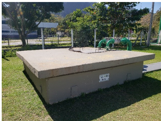
FIGURA 6-123 – ETE PRAIA DA CHÁCARA – TANQUE DE EQUALIZAÇÃO
