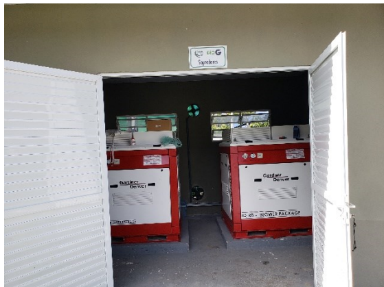
FIGURA 6-127 – ETE PRAIA DA CHÁCARA – SOPRADORES
