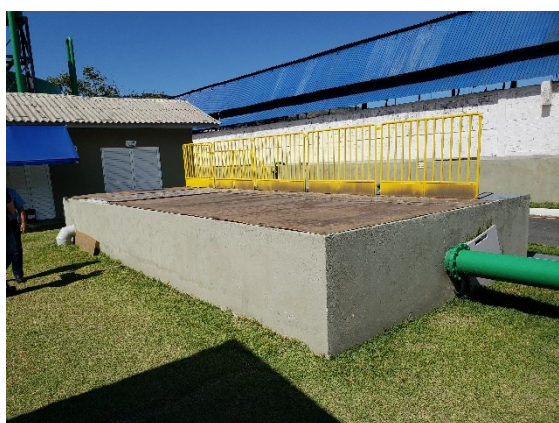
FIGURA 6-121 – ETE PRAIA DA CHÁCARA – CAIXA DE GORDURA
