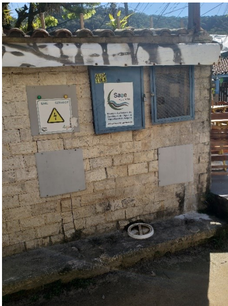
FIGURA 6-192 – EEE 03 – PADRÃO COM QUADRO ELÉTRICO
