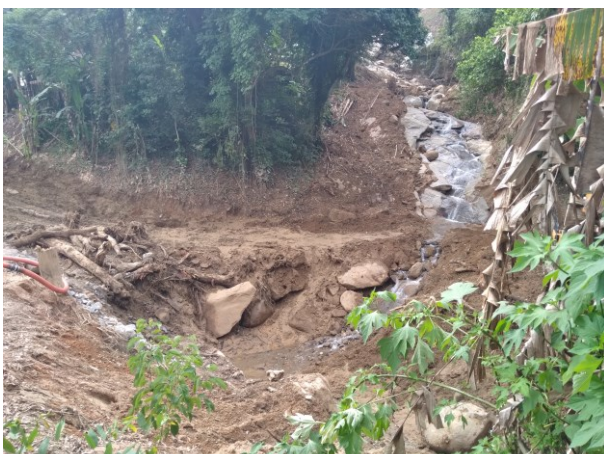
FIGURA 7-12 – ESCORREGAMENTO NA ESTRADA PARA PONTA LESTE
