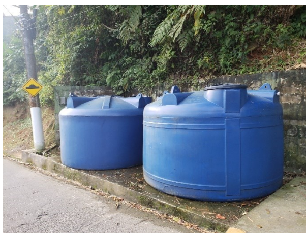
FIGURA 5-92 – VISTA DOS RESERVATÓRIOS – SAA BONFIM 02
