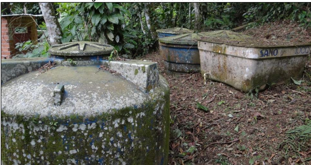
Figura 47 – Reservatório Ponta do Cantador
