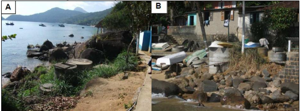
Figura 142 – Estações elevatórias de esgoto de Araçatiba
