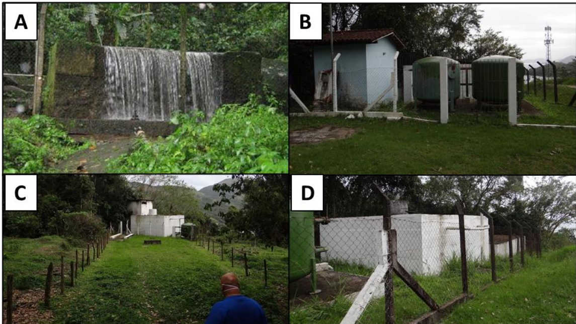
A:Barragem Monsuaba; B:Filração Galloway; C:Reservatório Galloway; D:Reservatório Vai Quem Quer. Fonte: PMSB e Município de Angra Dos Reis, 2021.
