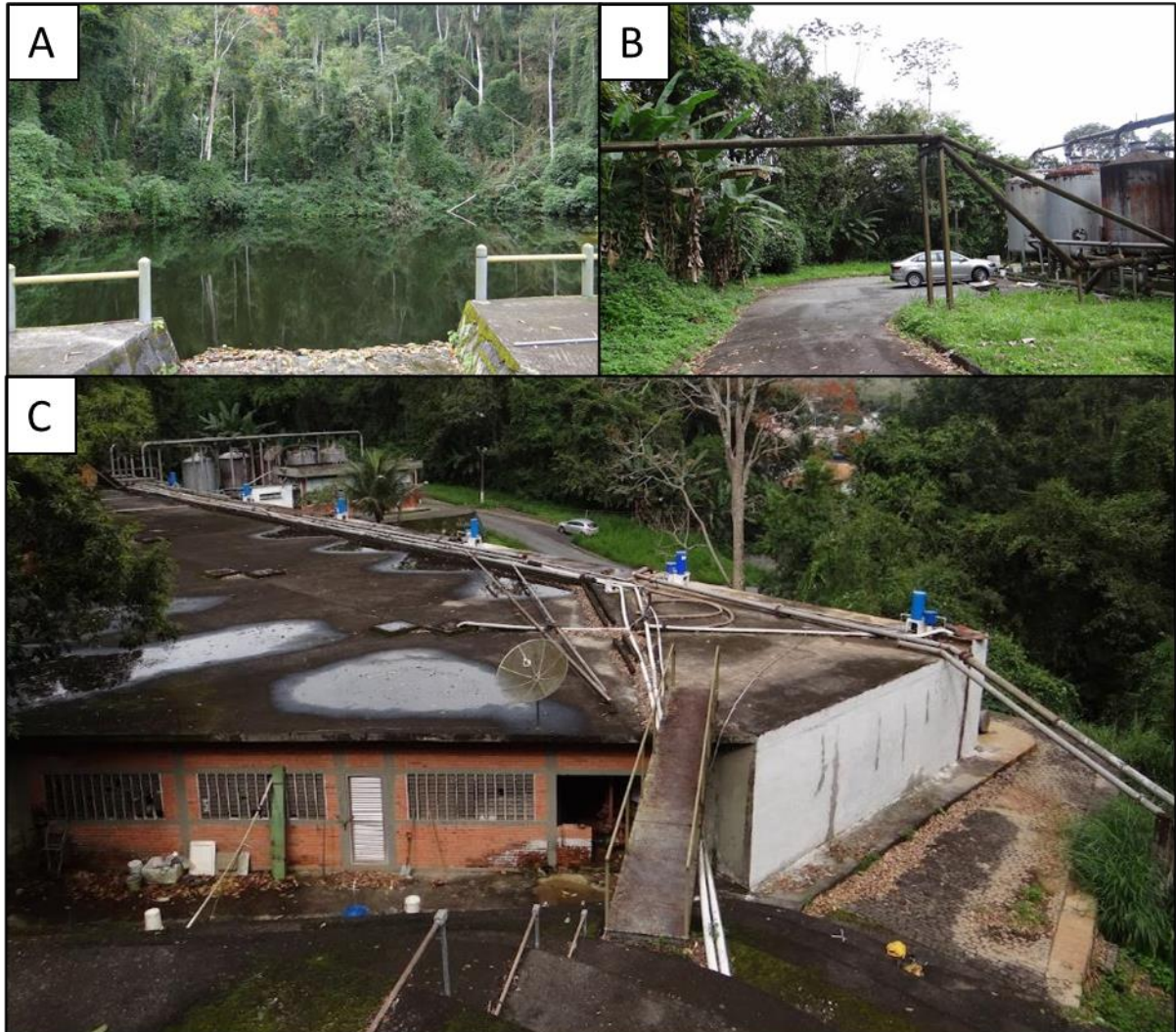
A: Captação Jacuecanga; B: Chegada tubulações de Caputera (Vitinho); C: ETA Jacuecanga Fonte: Município de Angra Dos Reis, 2021.
