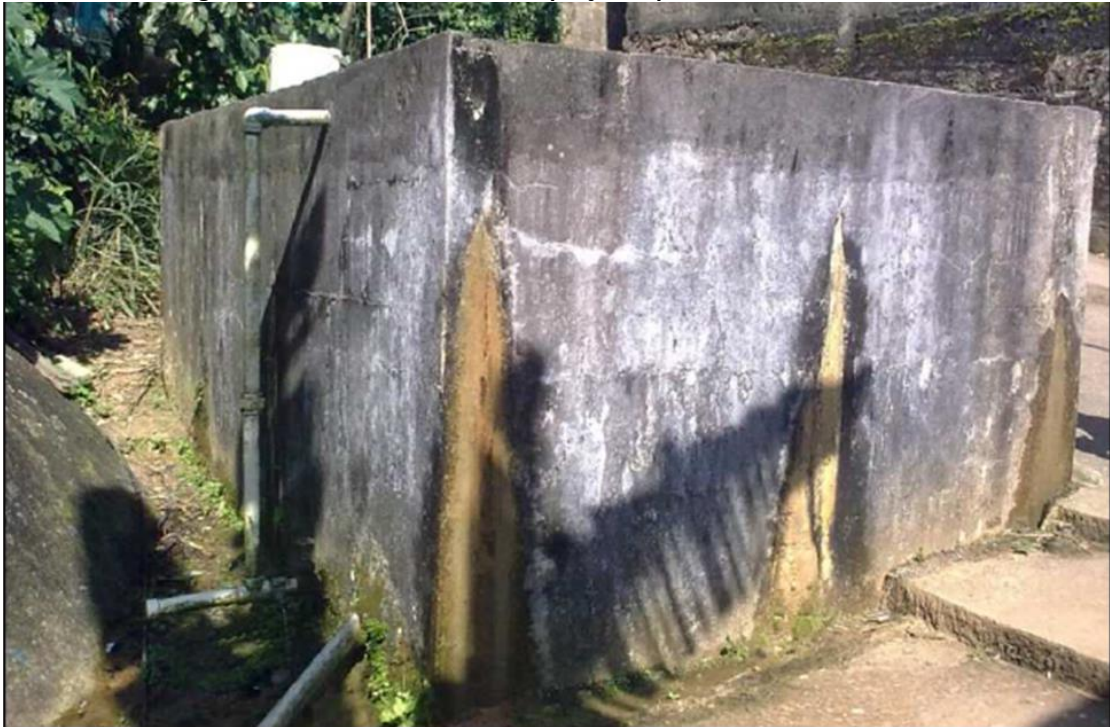
Figura 91 – Reservatório R2 da Captação superficial de Cotia/Castelo
