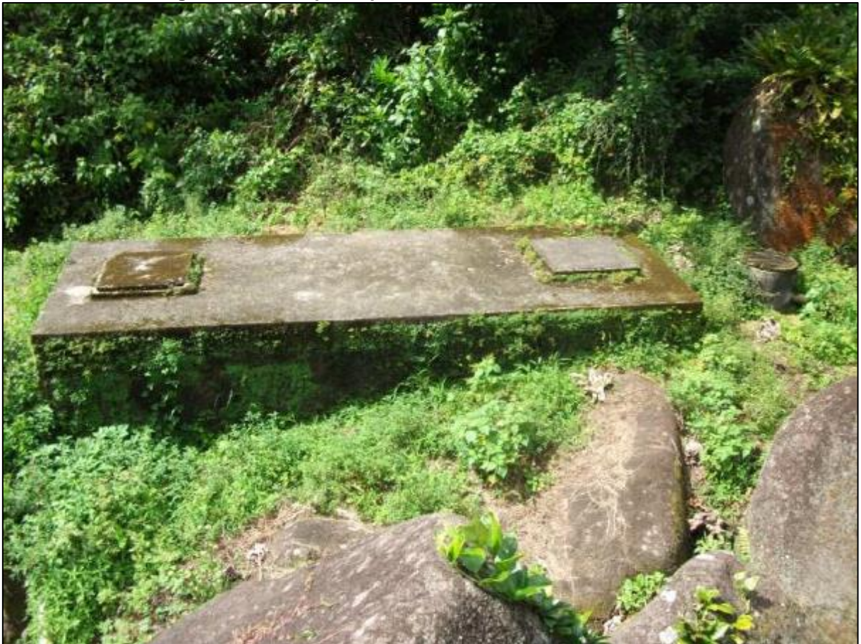
Figura 146 – Tanque Séptico do sistema Morro da Boa Vista
