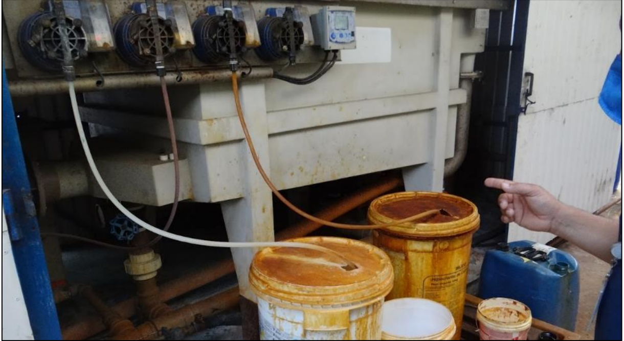
Figura 110- Tratamento Mecanizado de Lodo - Inativo
