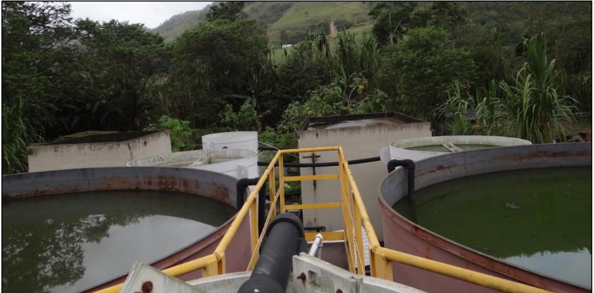
Figura 131 - ETE Banqueta MCMV
