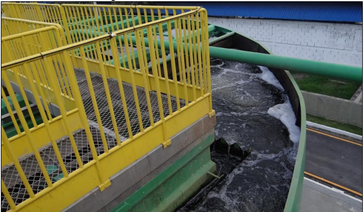
Figura 113 - ETE Praia da Chácara UASB
