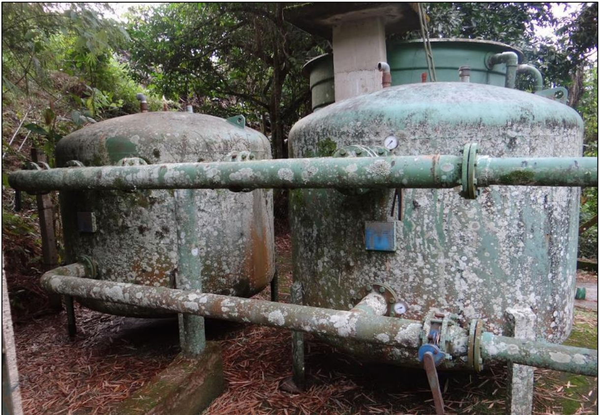
Figura 27 – Unidades de filtros rápidos pressurizados SAA Paraíso
