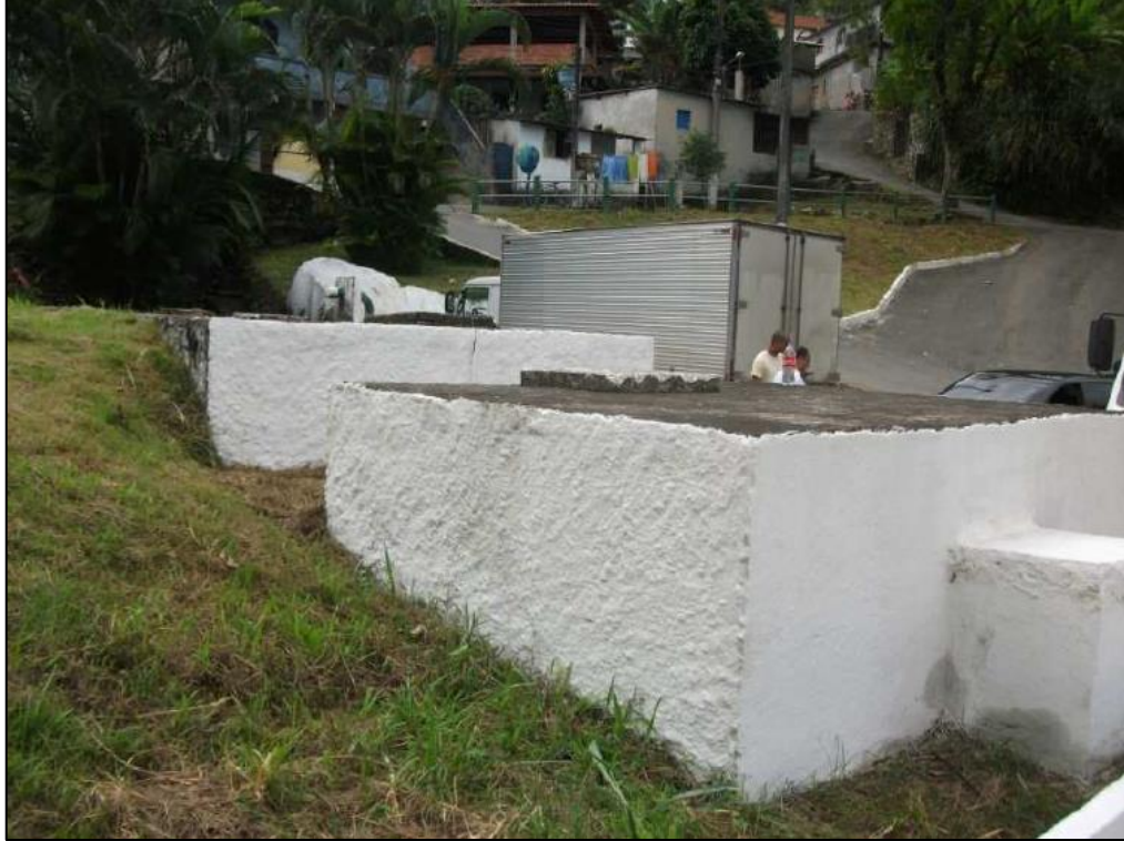
Figura 147 – Fossa filtro de estação elevatória
