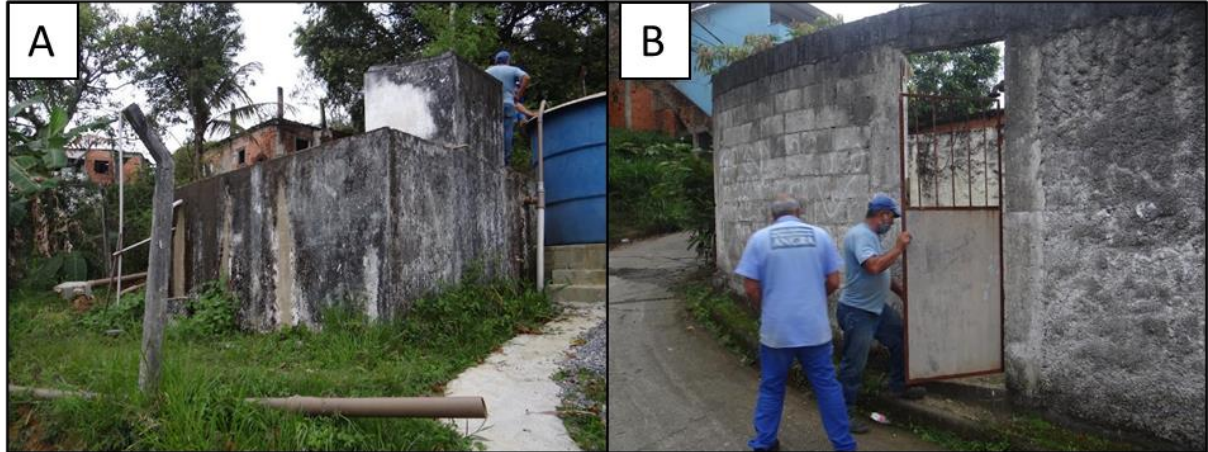
A: Reservatório Constância Superior; B: Reservatório Constância Inferior Fonte: Município de Angra Dos Reis, 2021.
