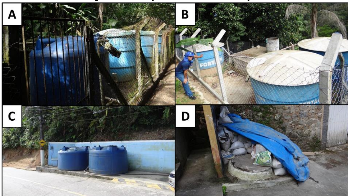
Figura 45 – Instalações do sistema de distribuição Bonfim
