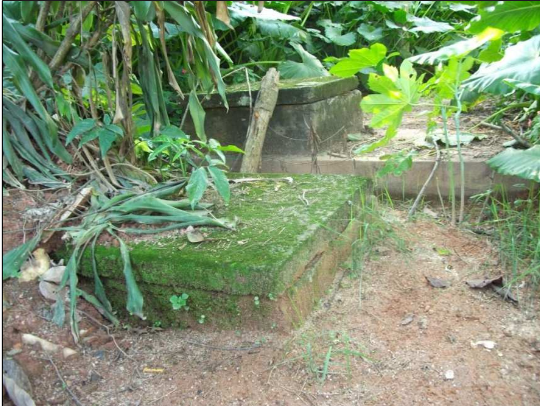
Figura 28.22. Fossa filtro de Campo Belo.
