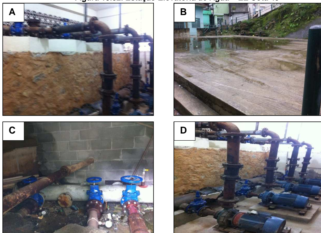
Figura 15.32. Estação Elevatória de Água – EE Cota 45
