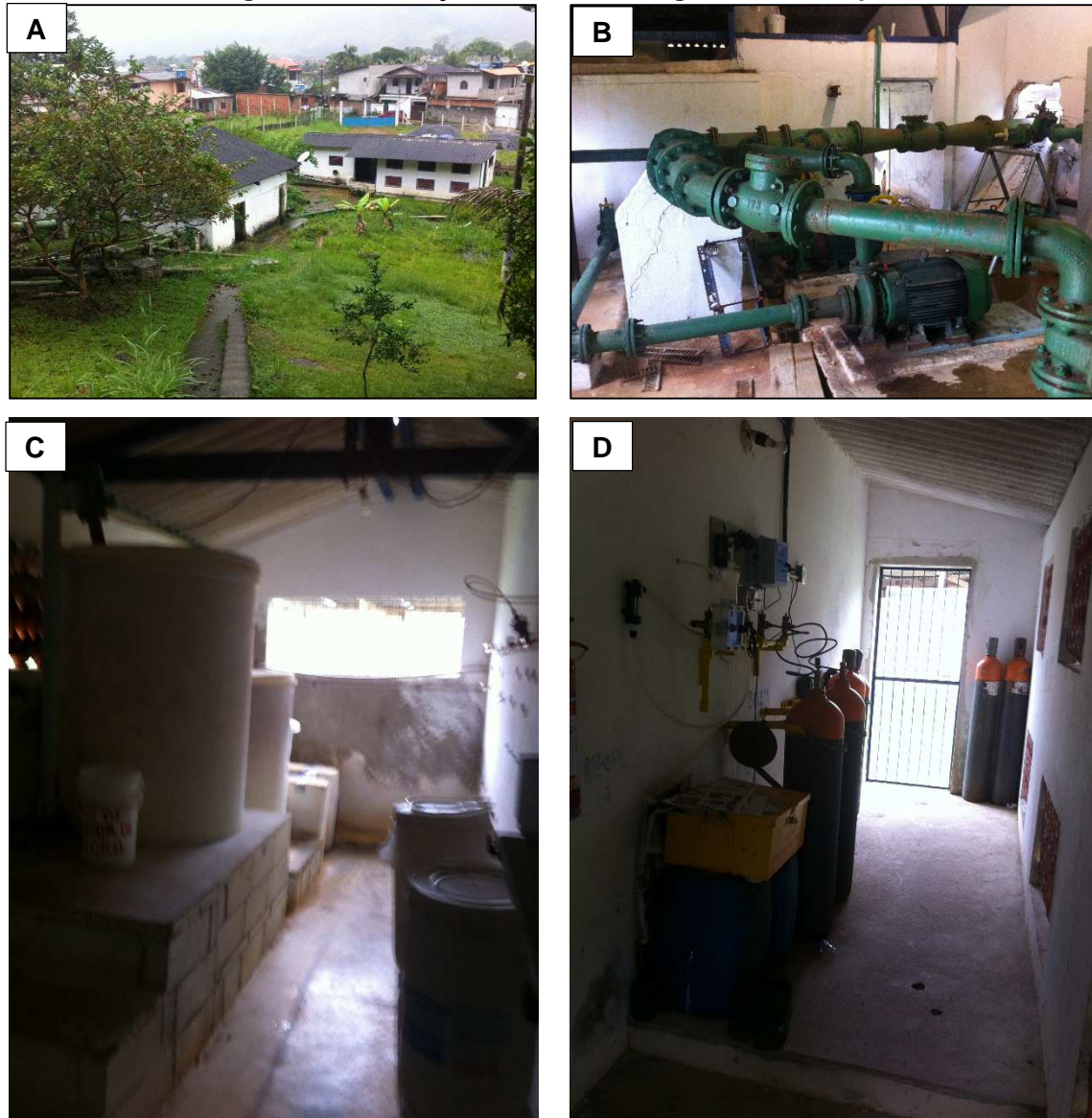
Figura 15.72. Estação Elevatória de Água Sistema Japuíba
