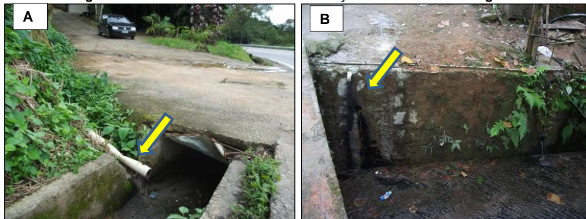
Figura 29.3. Efluentes sanitários sendo lançados na rede de drenagem
