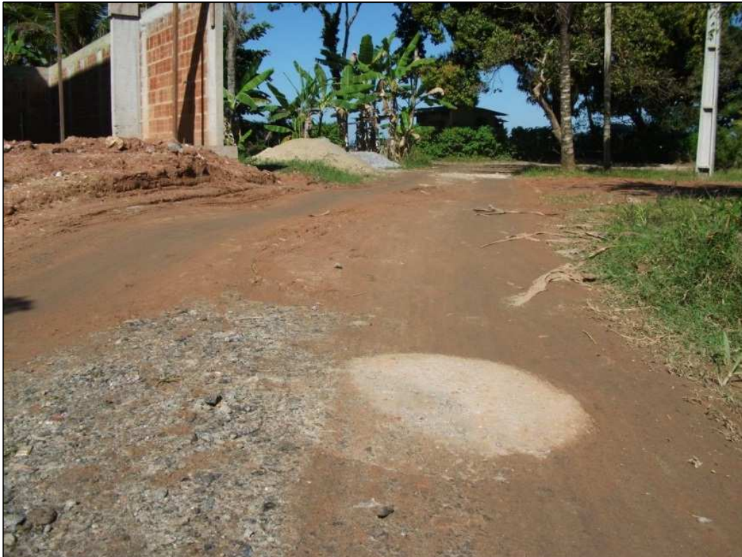
Figura 28.49. Via sem pavimentação na Localidade Praia do Recife
