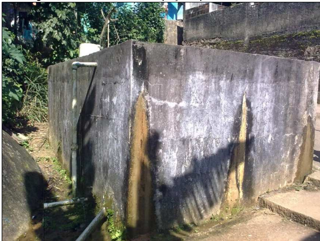
Figura 15.67. Reservatório R2 – Captação superficial de Cotia/Castelo
