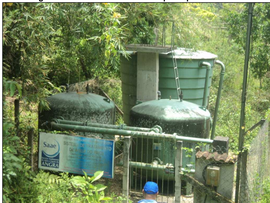
Figura 15.52. Unidades de filtros rápidos pressurizados.
