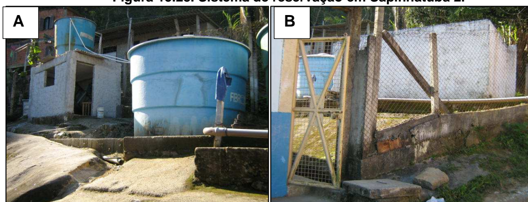
Figura 15.28. Sistema de reservação em Sapinhatuba 2.
