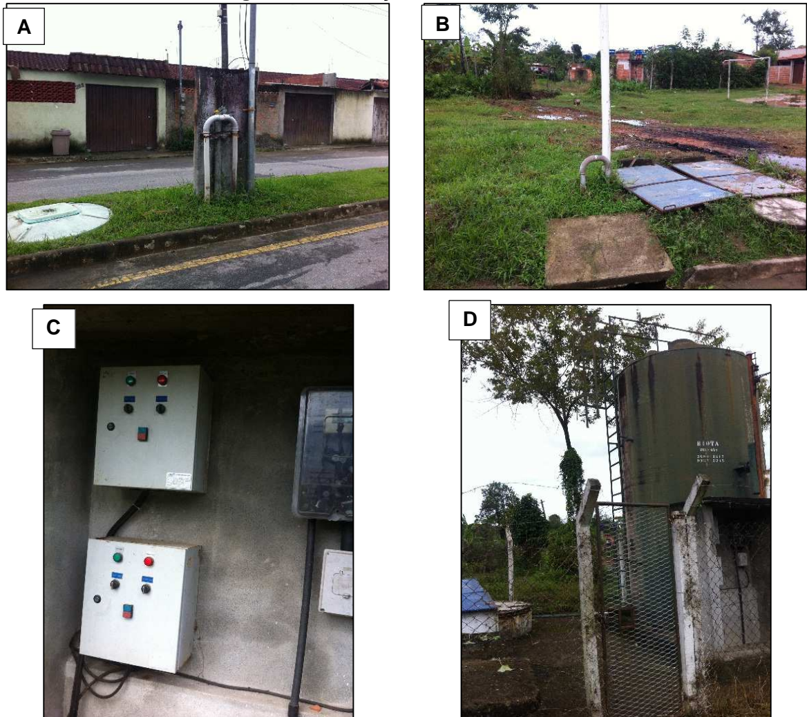
Figura 28.52. Estações Elevatórias Bracuí
