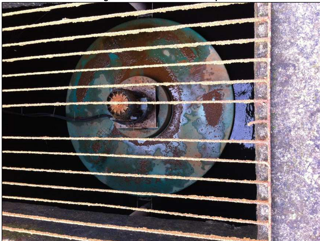
Figura 28.1. ETE Aerador Perequê.
