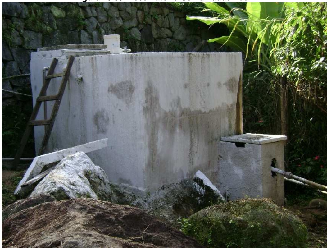
Figura 15.55. Reservatório Comunidade Rua 4.
