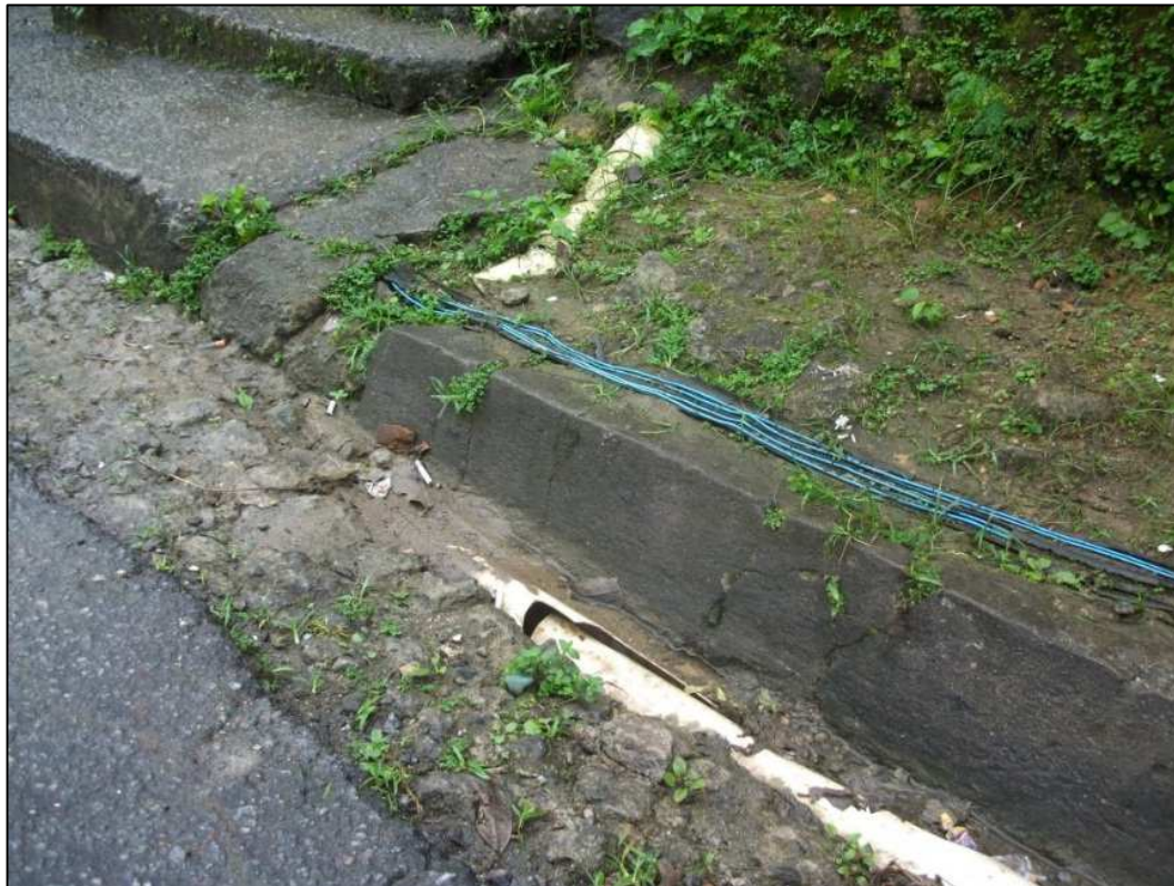
Figura 28.8. Rede de esgoto exposta e danificada e rede elétrica exposta - Monsuaba.
