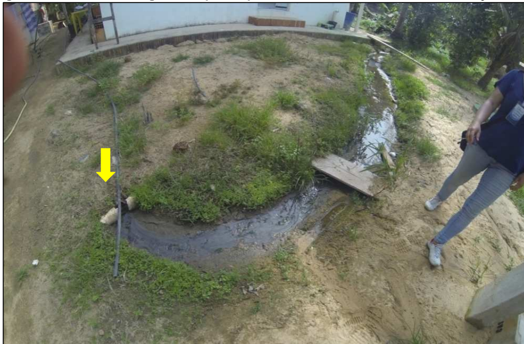
Figura 28.34. Rede de esgoto rompida, apresentando vazamento e contaminação local.
