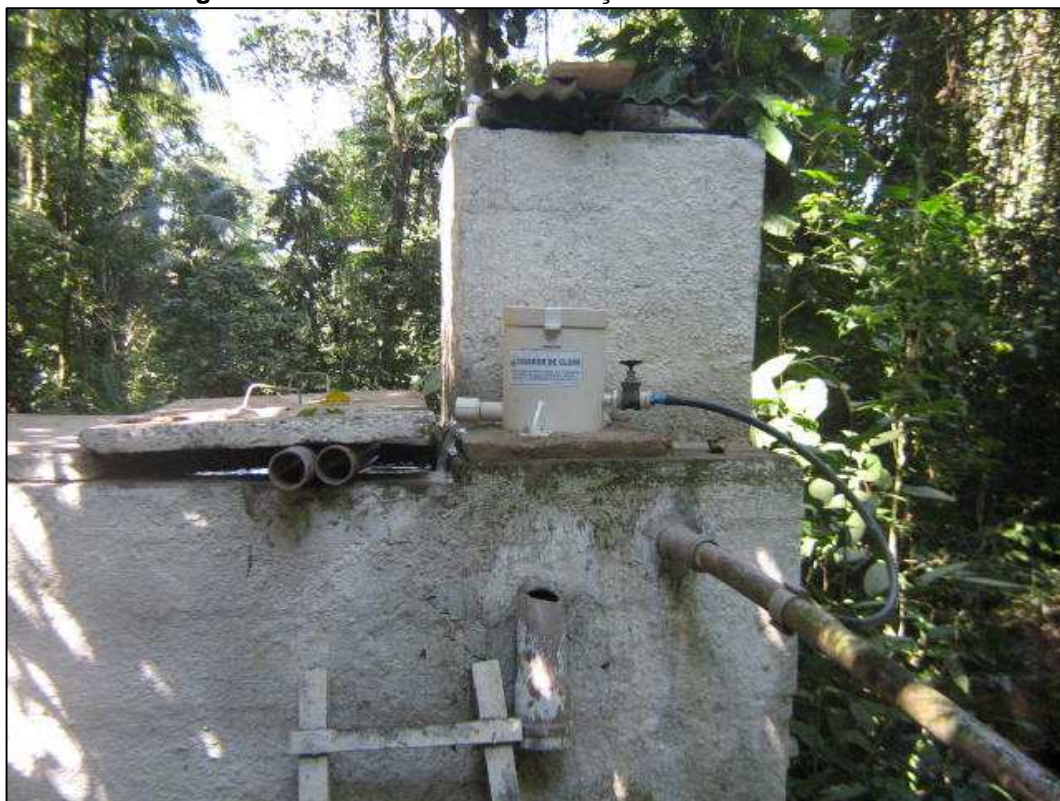
Figura 15.41. Sistema de desinfecção do Reservatório R1.
