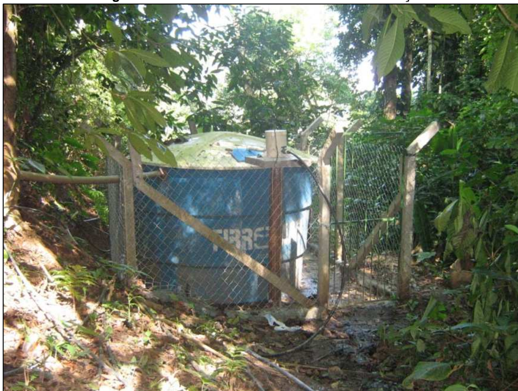
Figura 15.37. Reservatório e unidade de desinfecção
