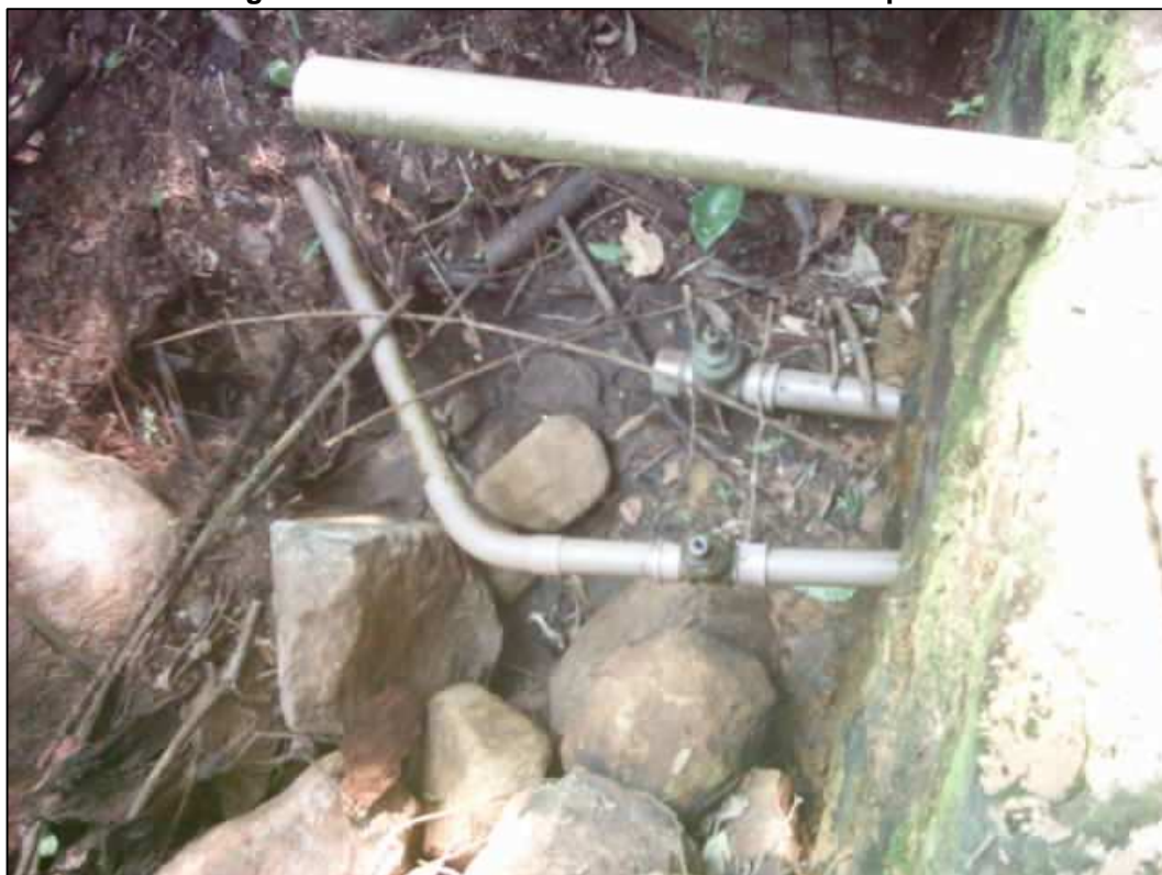
Figura 15.66. Saída do reservatório - Sistema Japariz.
