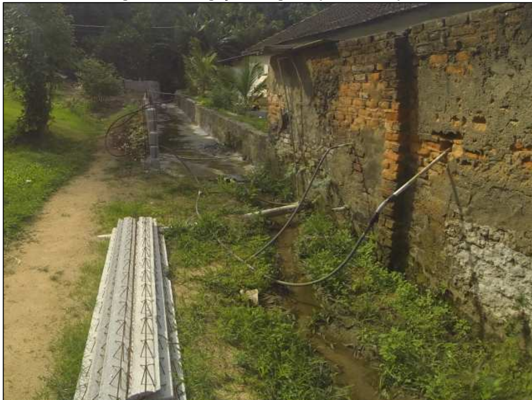
Figura 15.85. Ligação de água exposta em Japariz.
