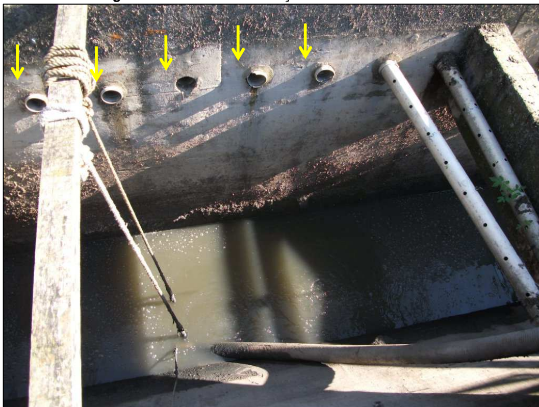
Figura 28.42. Falta de tubulação em câmara do RAFA.
