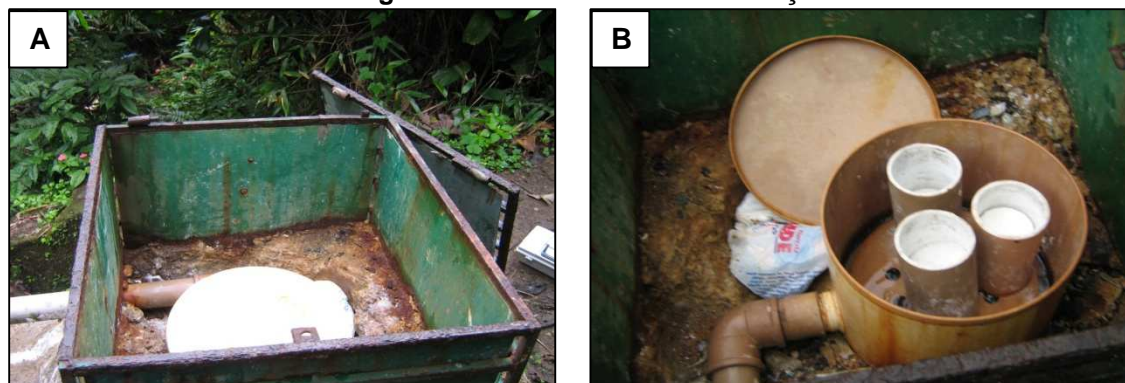
Figura 15.36. Unidade de desinfecção.
