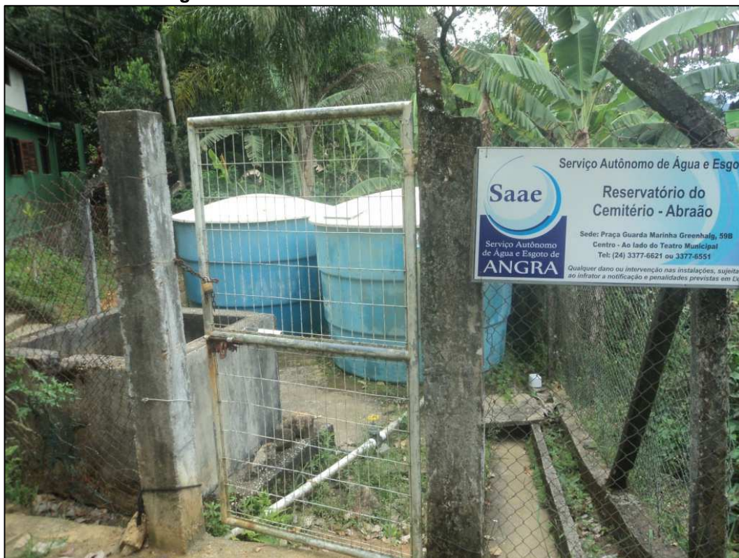
Figura 15.60. Reservatórios Morro do Cemitério.
