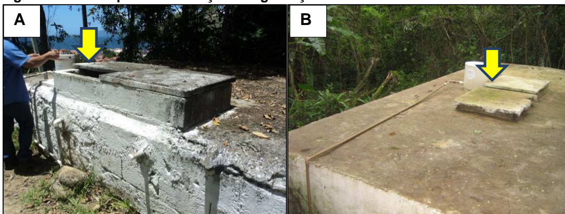
Figura 15.86. Tampas sem vedação e segurança em vários reservatórios do sistema.
