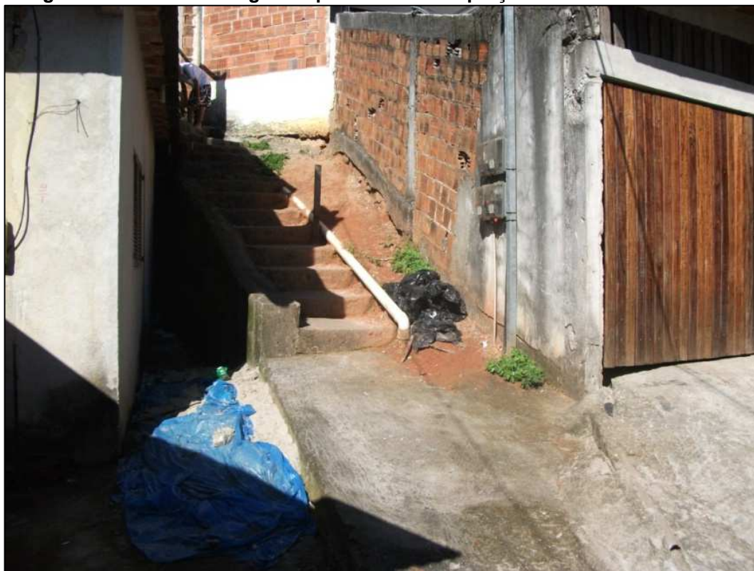
Figura 28.21. Rede de esgoto exposta em rua da porção à montante da BR-101.
