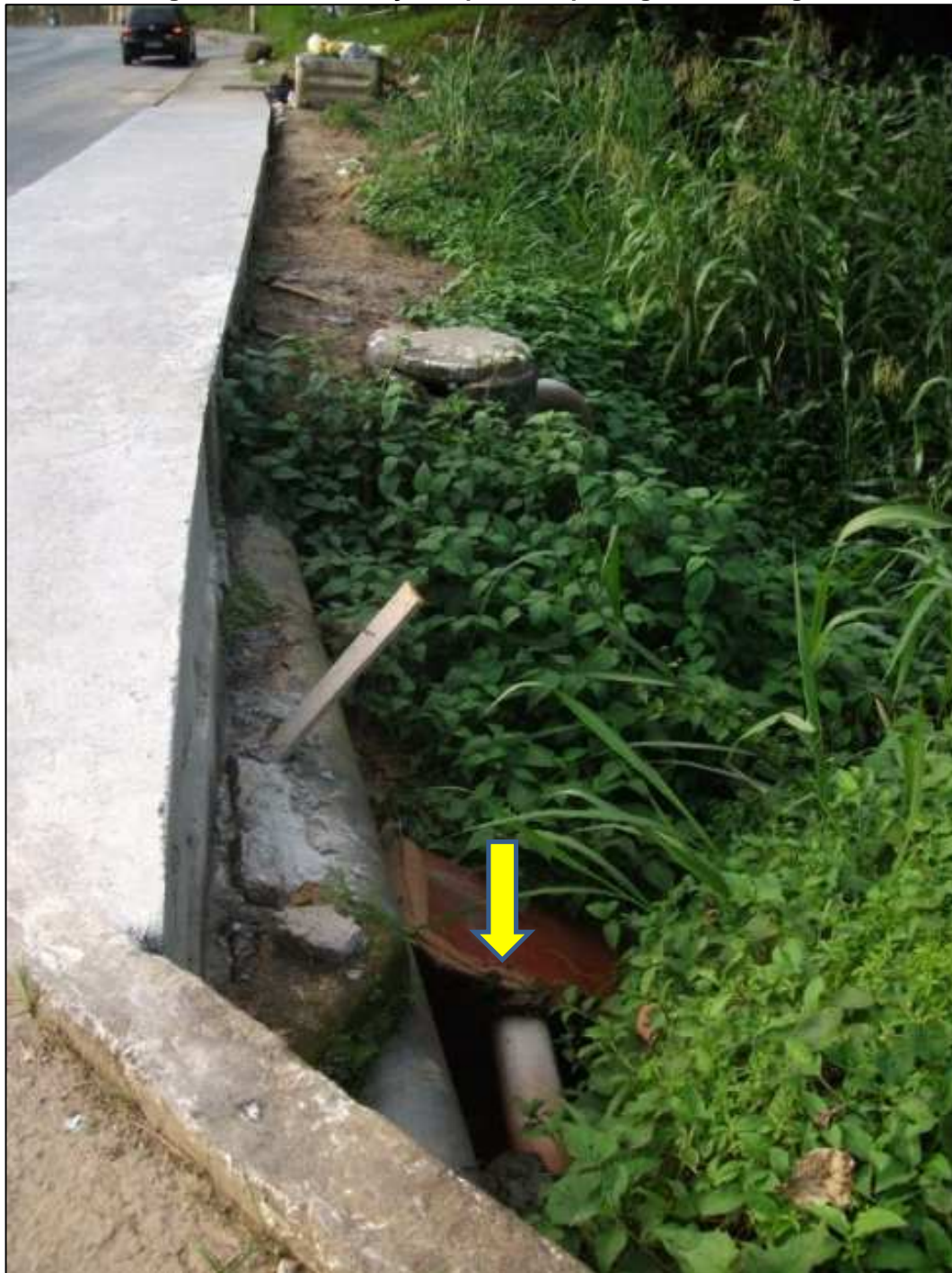
Figura 28.70 – Tubulação exposta na passagem do córrego
