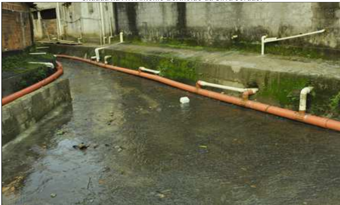
Figura 3.29. Redes de coleta de esgoto para condução dos efluentes à Estação de Tratamento situada na Av. Antônio Bertholdo da Silva Jordão.
