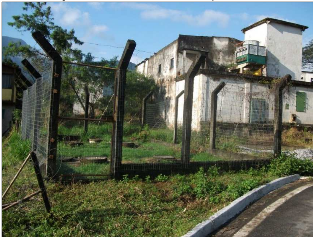
Figura 28.56. Unidade de Tratamento do tipo fossa filtro
