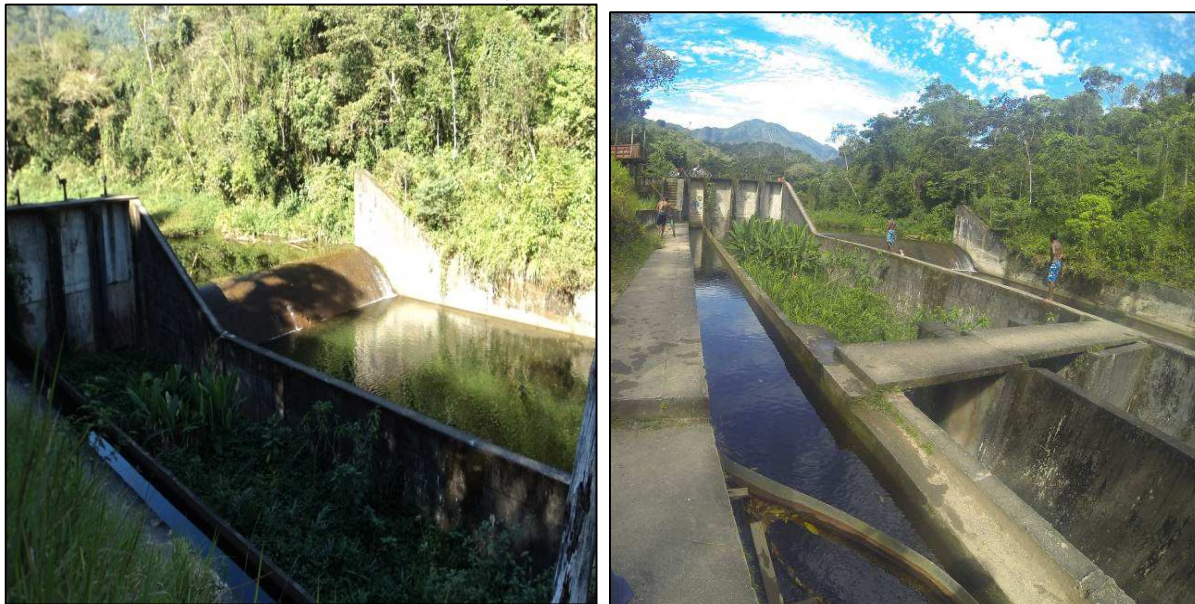
Figura 3.27. Captação Japuíba - Angra dos Reis –RJ.
