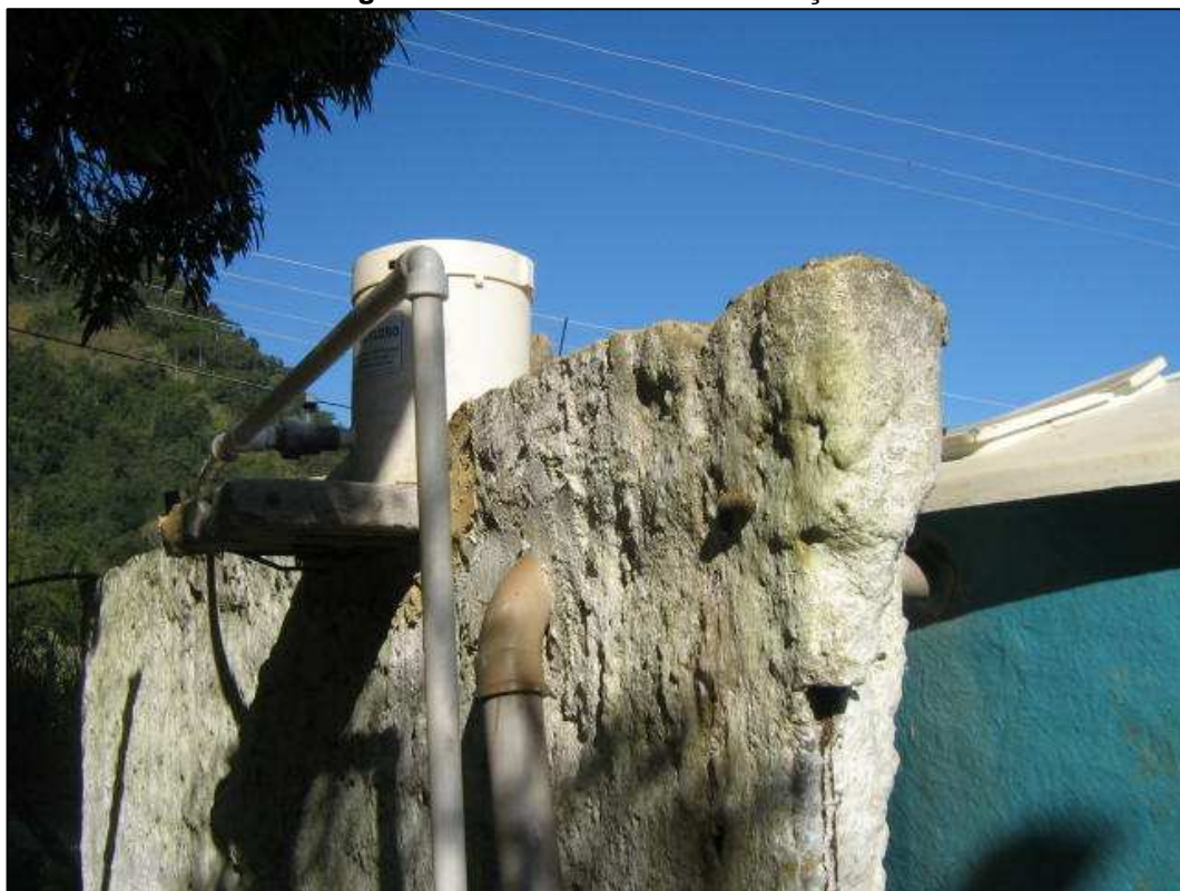
Figura 15.27. Sistema de desinfecção.
