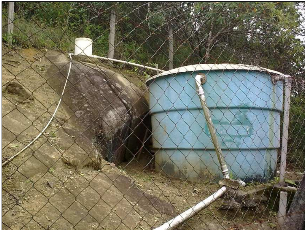
Figura 15.79. Reservatório Campo Belo
