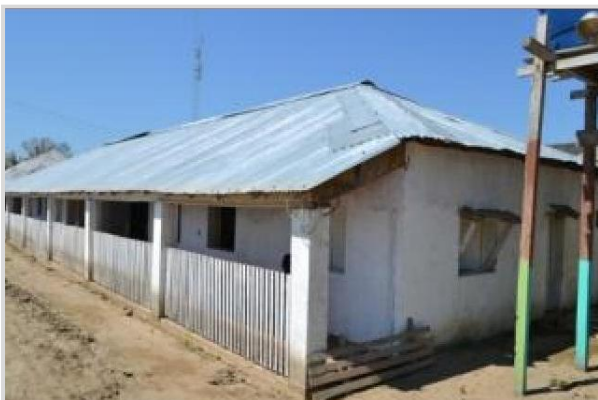
EMEF Castro Alves após a enchente (área frontal). Foto: CGU - Relatório de Fiscalização nº 201408699
