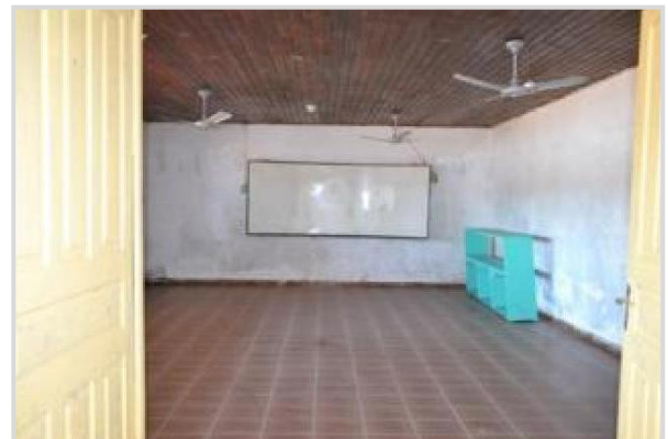
EMEF Castro Alves após a enchente (área interna). Foto: CGU - Relatório de Fiscalização nº 201408699
