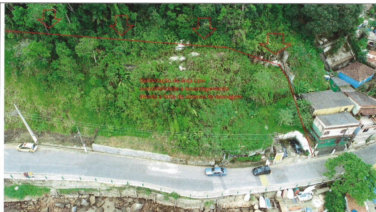
Foto 03: Vista com destaque para o trecho com ausência de sistema de drenagem complementar e grampeamento de solo, que pode resultar na remobilização da encosta e perda de parte dos serviços executados, foto SMA de 27/11/2018.
