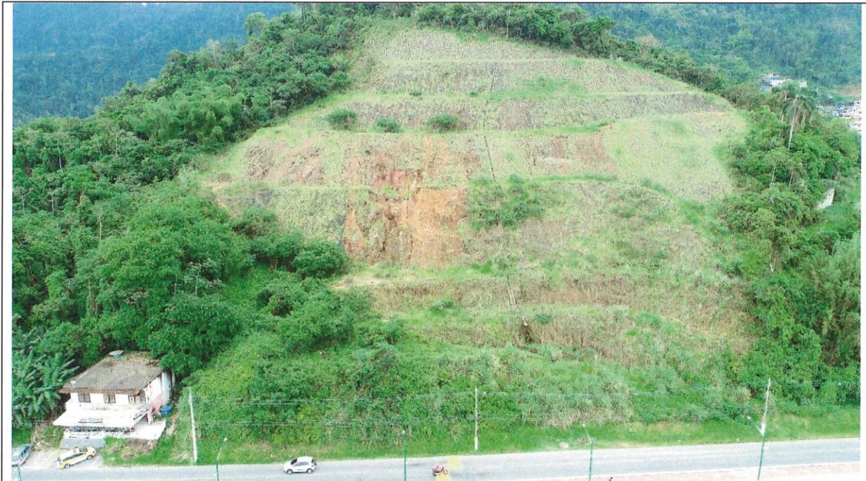
Fotos 07: Vista com destaque para cicatriz de erosão indicando a possibilidade de ruptura do solo, podendo avançar atingindo residência, poste público e resultar em bloqueio do acesso à Colégio Naval, foto SMA de 27/11/2018.
