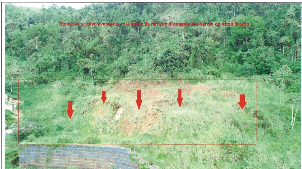
Fotos 10: Vista com destaque para o processo erosivo avançado mostrando a perda do serviço executado por falta das drenagens, foto SMA de 27/11/2018.
