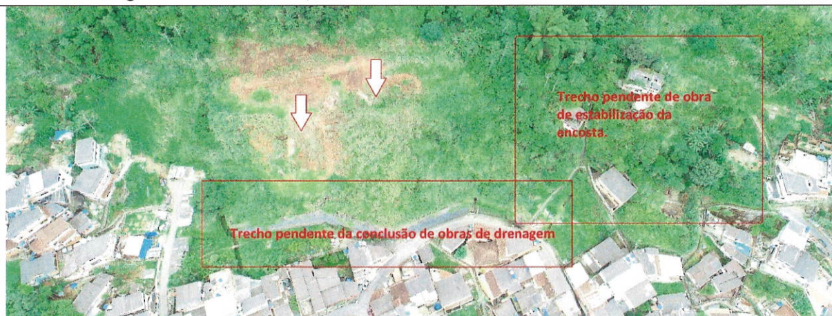
Fotos 09: Vista com destaque para o trecho pendente de conclusão das obras de contenção com o destaque das casas envolvidas e trecho com falta de drenagem das águas de chuva, foto SMA de 27/11/2018.
