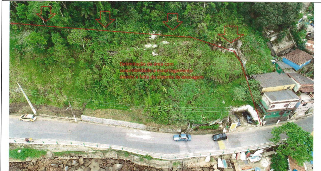
Foto 03: Vista com destaque para o trecho com ausência de sistema de drenagem complementar e grampeamento de solo, que pode resultar na remobilização da encosta e perda de parte dos serviços executados, foto SMA de 27/11/2018.
