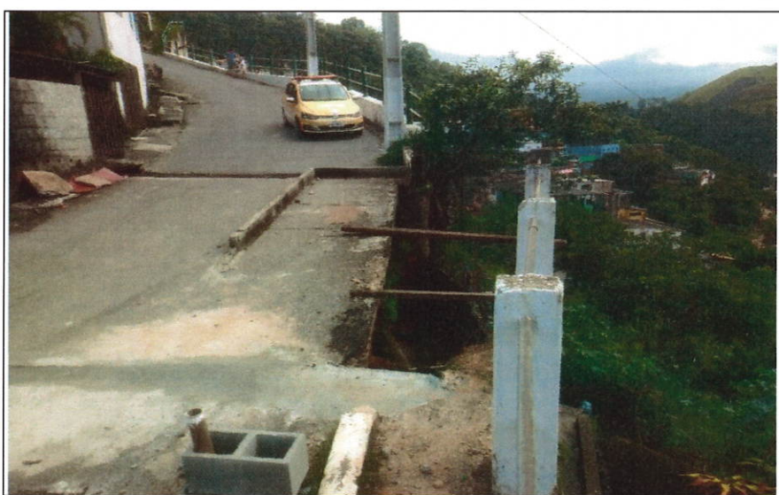
Fotos 11: Processo erosivo avançado marcando o início de perda da obra e investimentos, sendo necessária ação imediata.
