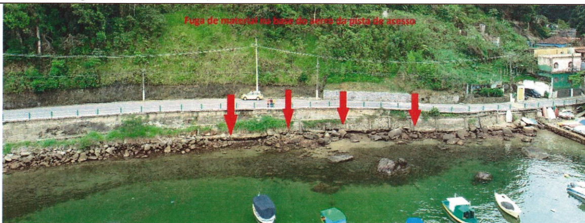
Foto 02: Vista com destaque para o ponto de fuga de material na base do aterro do acesso aos bairro da Estrada Vereador Benedito Adelino, foto SMA de 27/11/2018.
