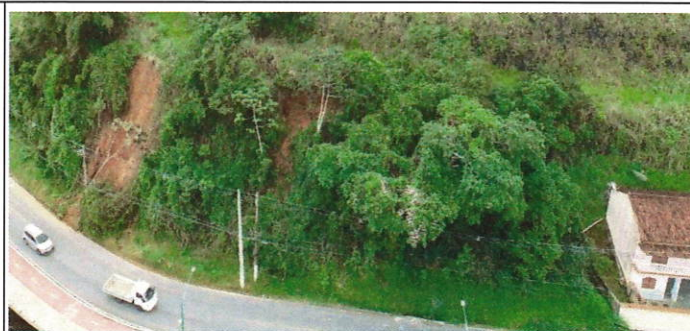
Fotos 06: Vista com destaque para cicatriz de escorregamento indicando a possibilidade de ruptura do solo, podendo avançar atingindo residência, poste público e resultar em bloqueio do acesso à Colégio Naval, foto SMA de 27/11/2018.
